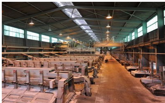
Beispiel 2: Elektrolyseöfen bei Trimet
